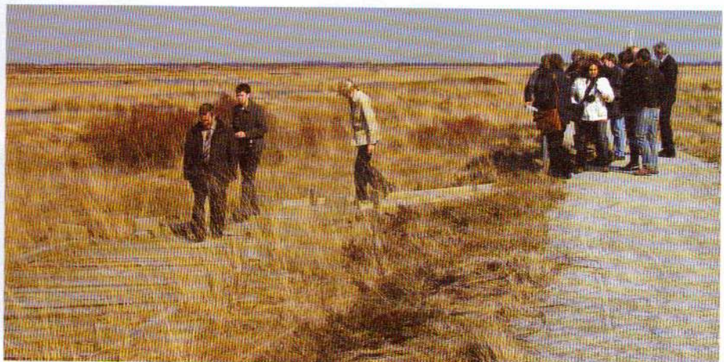
Ein Teilstück des Rundweges wurde von der Fa. Wilken, Neufirrel, als Bohlenweg gebaut.
